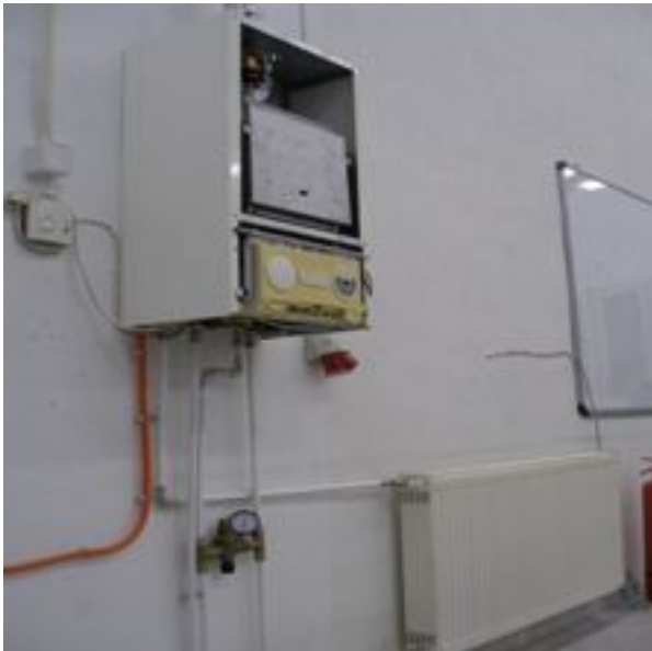
Εικόνα 1. Σίατρη καυστήρα φυσικού αερίου
